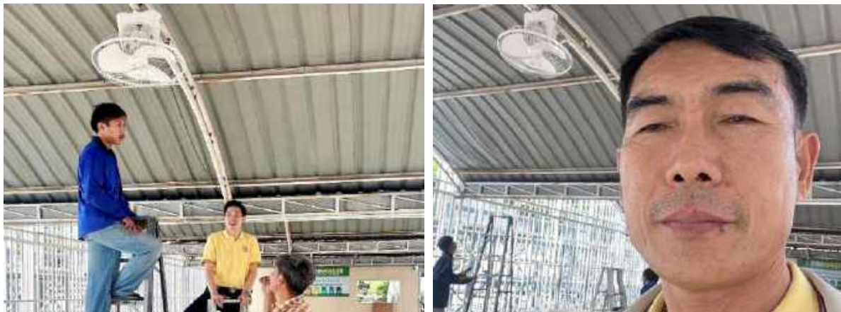
ภาพที่ ๑๒ การติดตั้งพัดลมเพดาน บริเวณโถงกิจกรรม
