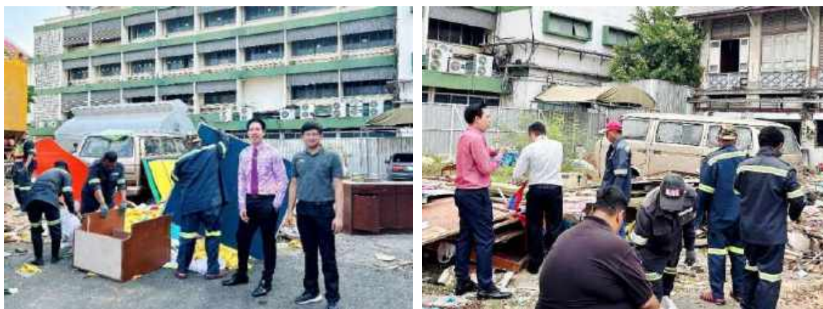
ภาพที่ ๕ การจัดเก็บสิ่งของที่ไม่สามารถใช้งานได้แล้วหรือขยะต่าง ๆ ออกจากอาคารต่าง ๆ
