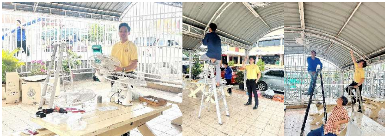
ภาพที่ ๑๕ การติดตั้งพัดลมบริเวณจุดนั่งพักผ่อนของนักเรียน
