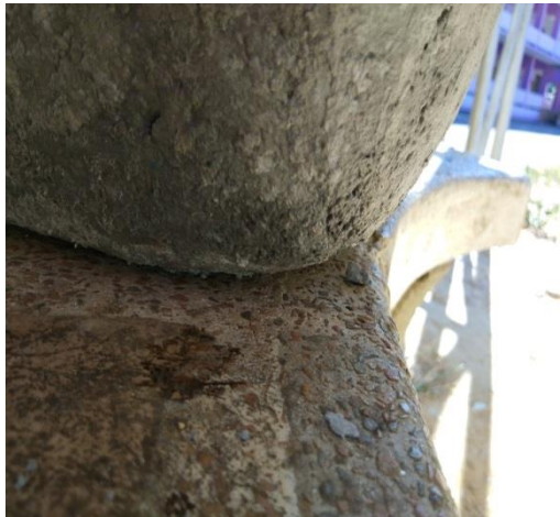
น้ำรั่วซึมที่มุม
